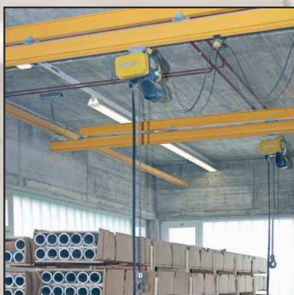
* Grúa suspendida monorraíl.
